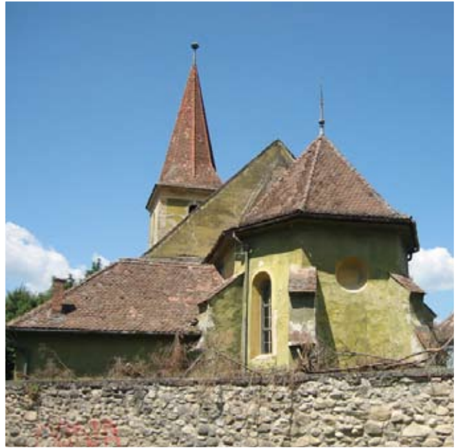
2007: Die Kirche in einem dramatisch äußerlichen Zustand
